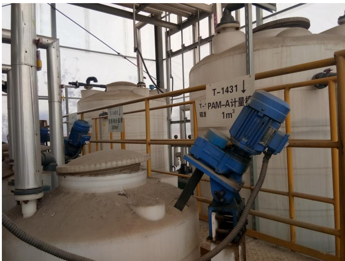
图 3-2 直接接地的地上储罐
